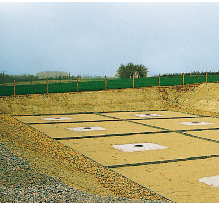
Filtres à sable.
